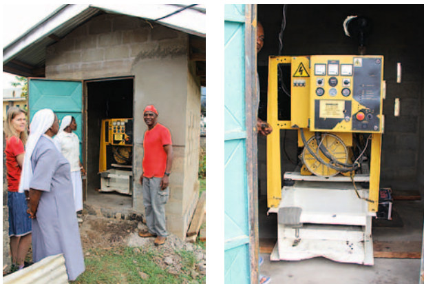
Ein neuer Generator für das Spital Bali Nyonga.
