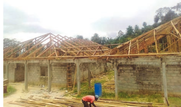
Dezember 2019: Konstruktion des Daches für unsere Entbindungs-/Krankenstation und den Operationssaal in Mbetta.
