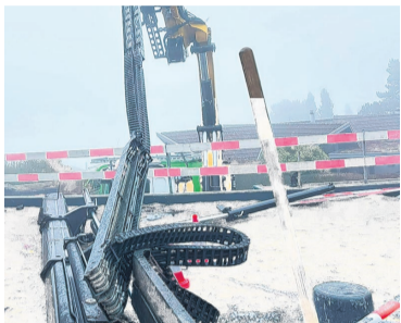
Der Kran am Unfallort.
